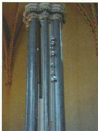
5. A kötőpillérek hornyaiba szerelt három áramkörös, 230 V-os áramvezető sín
