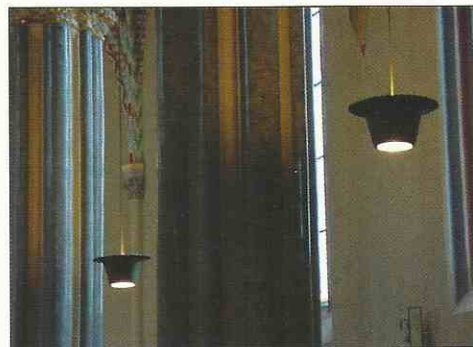
4. A hívők padsorát világító, részlegesen felújított „kettős vetítő” {( 3×20 W kompakt fénycső, ( 1×100 W TUNGSRAFLEX]
